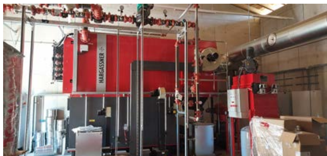
Das ist der große Ofen, der die Hackschnitzel verbrennt und damit das Wasser erhitzt.
