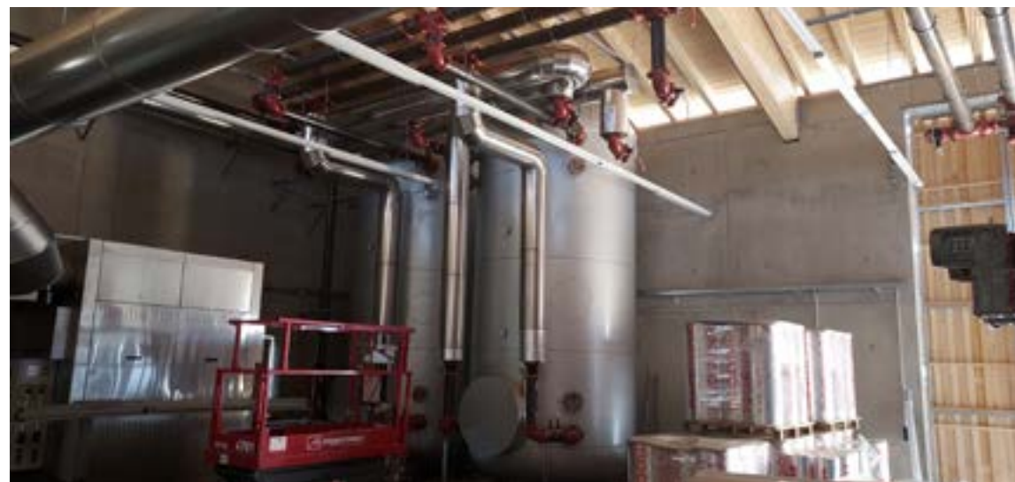
In diesen beiden Kesseln wird das heiße Wasser gespeichert
