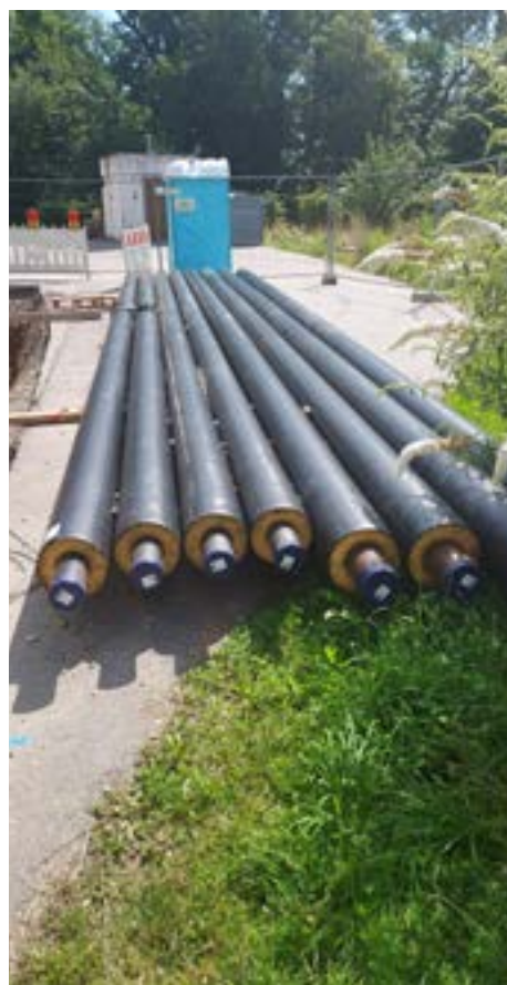
Diese sogenannten Fernwärmeleitungen wurden in den Gräben verlegt. Sie transportieren das heiße Wasser vom neuen Heizhaus in die einzelnen Gebäude.
