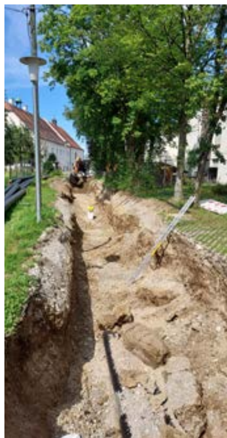
Ein tiefer Graben zog sich vom Carport bei den Bussen bis hin zum alten Heizhaus neben dem Obstgarten. Die Firma Rieder hat immer gut aufgepasst, dass alles gut abgesperrt war und mit kleinen Brücken trotzdem die Gräben überwindbar waren.
