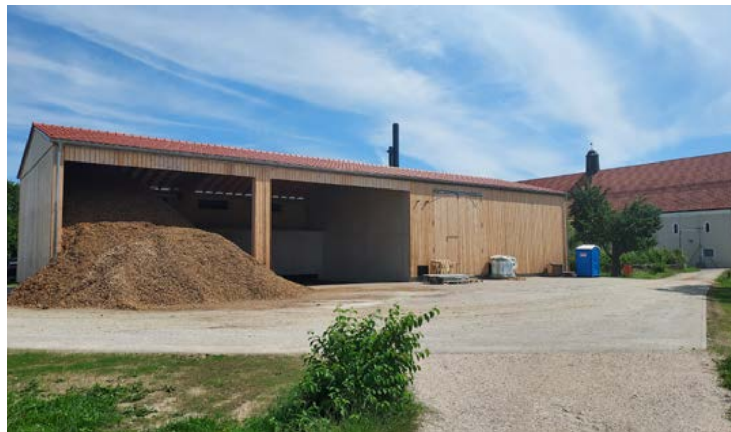
Das Lager ist mit Hackschnitzel befüllt, in der Mitte ist das Transportband, das die Hackschnitzel später zum Ofen transportiert. Rechts im verschlossenen Bauteil ist die Heizung untergebracht
